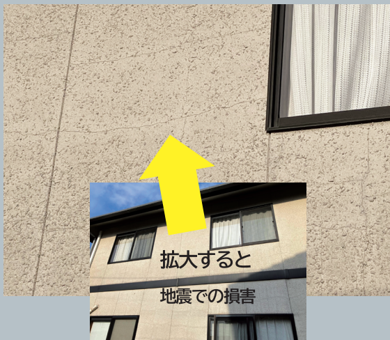
「一見なんともない外壁が…」 2024 2/3(土)
